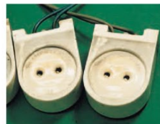
ランプソケットの汚損がひどく、クラックも入っています。更に内部の導電板も著しく酸化しています。
