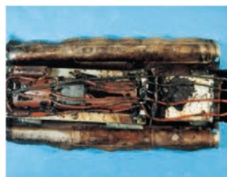
ビニル電線被覆が熱のために変形し、もろくなっています。
