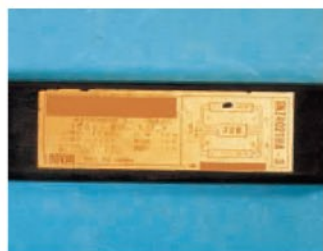
熱によって銘板が変色しています。
