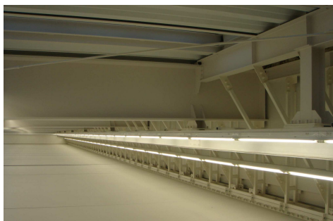
図 3.13 ガラスクロス天井懐内照明
