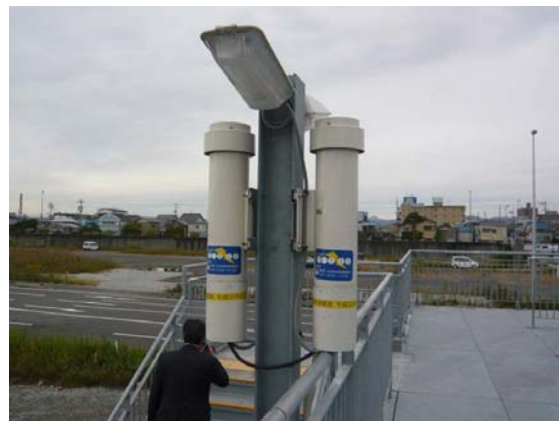
津波緊急待避施設用照明
