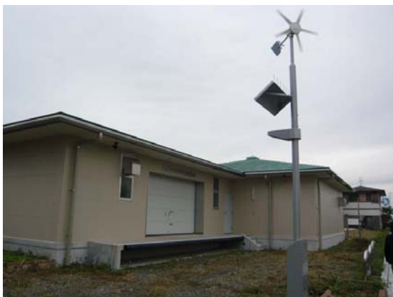
備蓄倉庫の風力・太陽灯用照明
