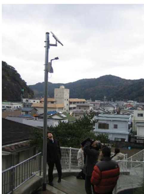
F-3 ソーラー式非常照明
