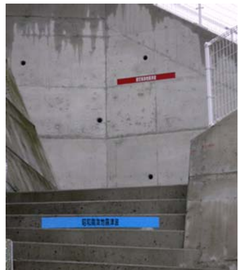
図4.1.13 津波高さ表示シール
