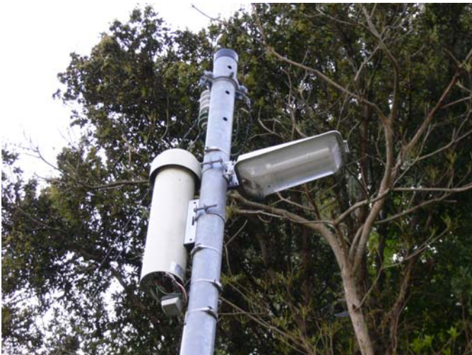
串本町 避難経路の UPS 付街路灯
