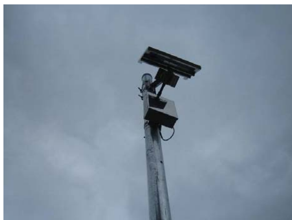
F-5 ソーラー式非常照明
