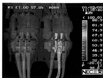
画像1 配電盤内接続部異常
