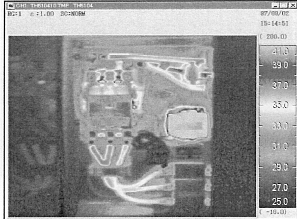
図4.12 電源配電盤の表面温度
