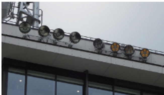
図6 屋上の投光照明 左4台が災害時HID光源、右4台が平常時兼用LED光源
