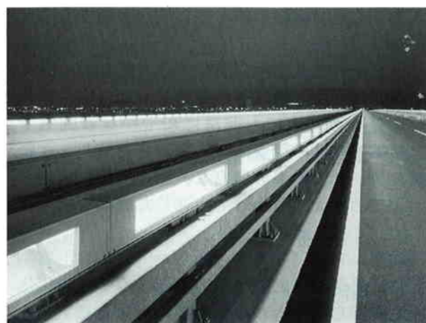
高欄照明器具
